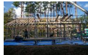
↑施工中の写真。なにもないところから建物の形が姿を現す過程は、建築設計をしていて最も喜びを感じる瞬間です。
